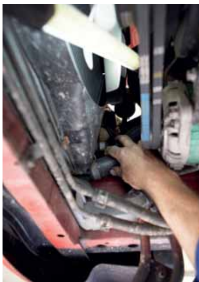
Controle van het leidingwerk en de overige delen van het koelcircuit: wie doet dat niet tijdens een normale beurt? Inwendige vervuiling is storingsoorzaak nummer 1 bij kapotte waterpompen.
