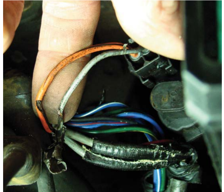
Een simpel kabelbreukje, maar het lokaliseren ervan vraagt een gestructureerde aanpak.
