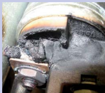
Pool weggebrand. Oorzaak: contact niet goed aangedraaid.
