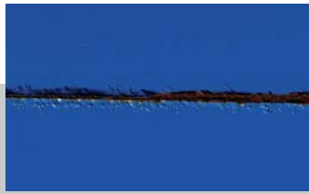
Hier gaf een mechanische beschadiging aanleiding tot corrosie. Als het blanke metaal vochtig is voor het gronden, ontstaat corrosie zonder beschadiging van buiten.
