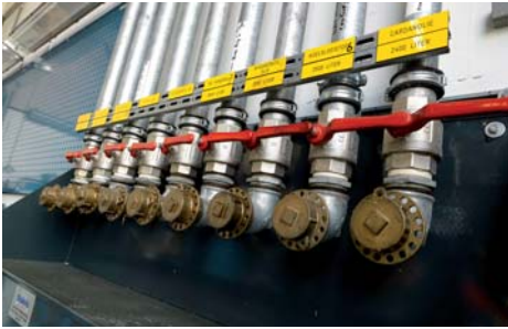
Indrukwekkend, negen aansluitpunten voor de tankauto's. De Kiwa-lekbak eronder is maatwerk. De volledige leidinginhoud past er in.
