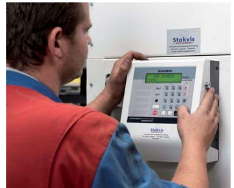
Aftappen lukt alleen na invoering van login en werkopdrachtnummer. Voordeel: de vloeistof komt automatisch op werkopdracht en factuur.
