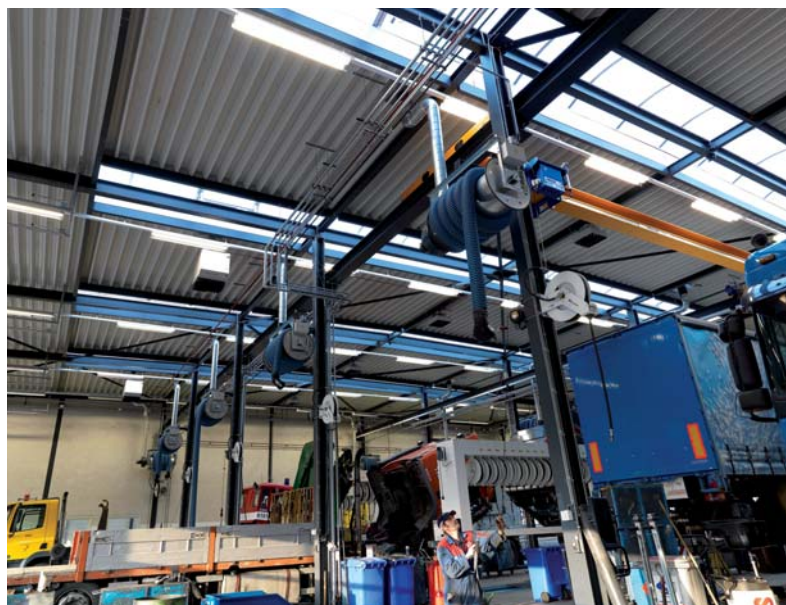
Energiebesparing: de ventilator van de uitlaatgasafzuiging gaat pas aan als de slang (elektrisch) zakt. Werkplaatsefficiëntie: niet alleen in de kabinetten, maar ook op iedere kolom zit een luchthaspel en een looplamphaspel. Verder extra luchtpunten tussen de roldeuren. Licht en lucht zijn altijd ruim voorhanden.
