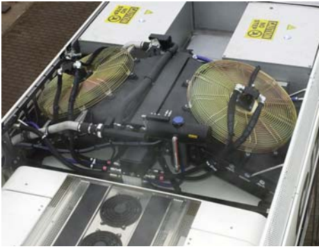
De temperatuur in de brandstofcel loopt op tot 75°C, grote ventilatoren op het dak helpen deze warmte afvoeren.
